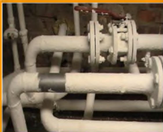
Теплоизоляция труб в ЦТП с нанесением КТВП
